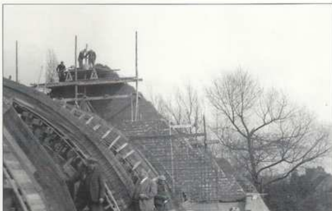
De kerkenbouwers bezig aan de dakwerken. Vooraan staan de aannemers Lambert Heestermans en Maurice Verbeke, op inspectie.
